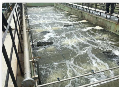
臺南安順排水淨化場
